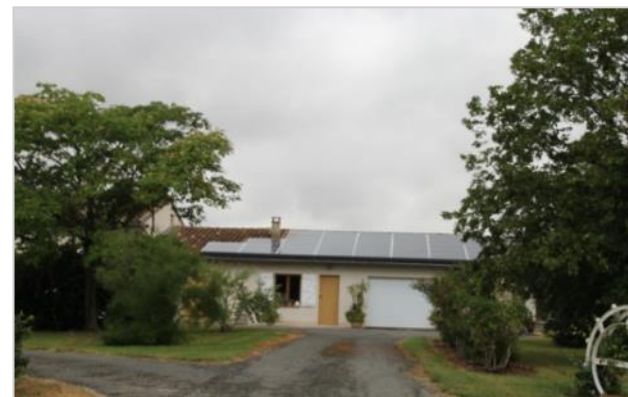
Figure 86 : Panneaux photovoltaïques sur toiture
